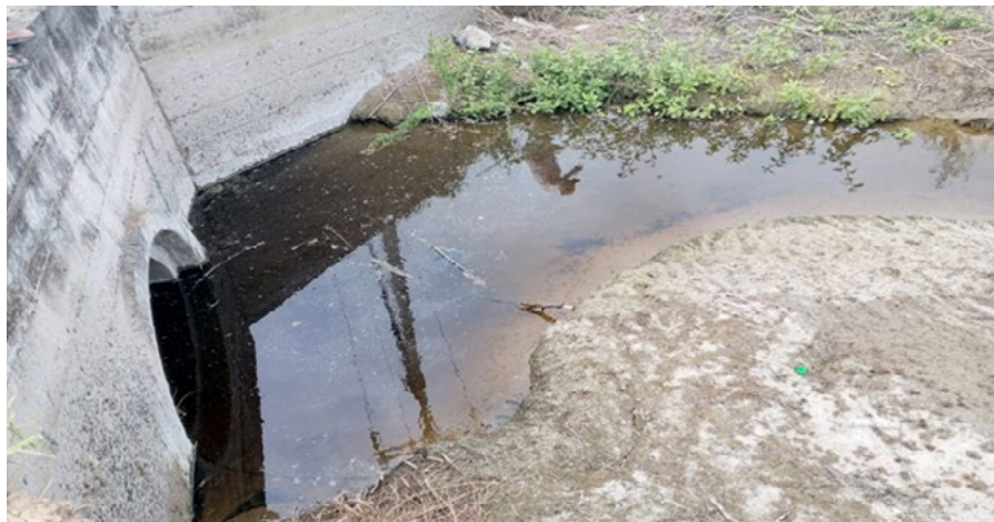
Conducto abierto de las aguas ya tratadas
