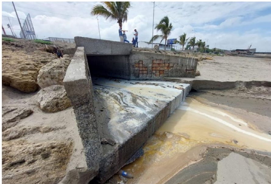
Desagüe de aguas servidas directo al mar Colectivo Ar-tos
