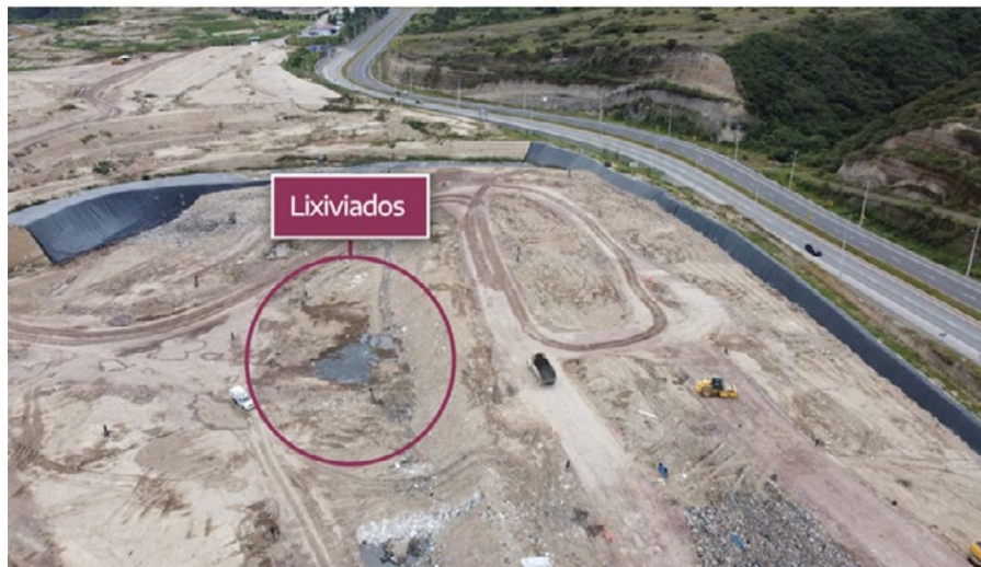
Filtración de lixiviados a la superficie 26
