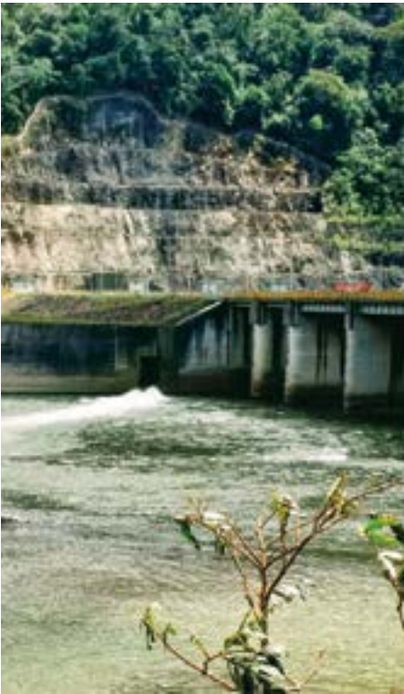
Punto de salida de agua de la hidroeléctrica
