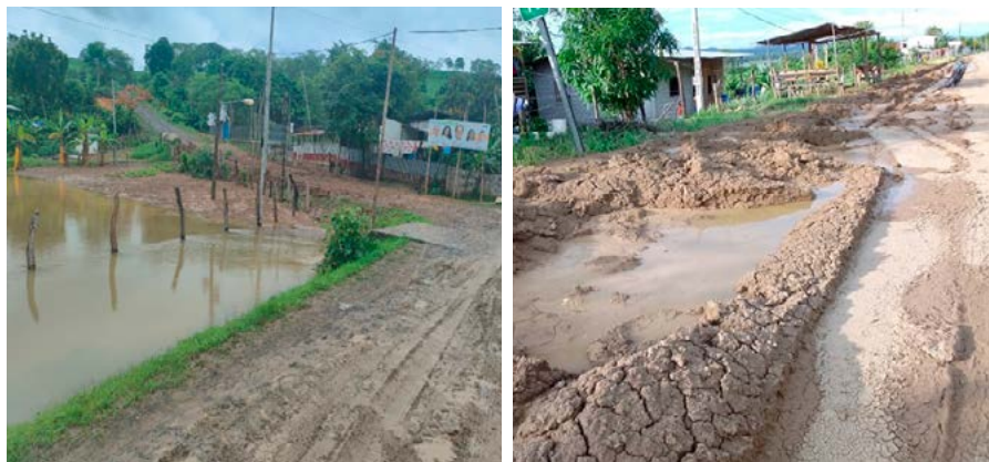
Carretera destruida Foto: Ferdinand Muñoz
